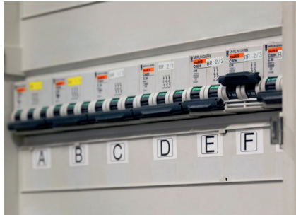
Kennzeichnung von Schutzschaltern
