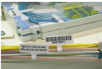
Kennzeichnungen von Glasfaserkabeln
